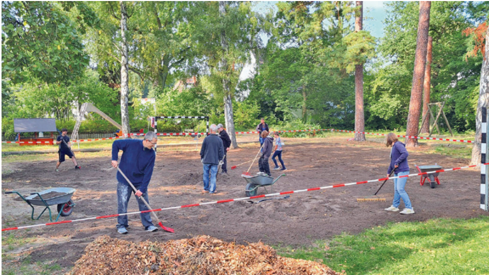
Wurzeln raus, Erde drauf, glatt gezogen, Rasen rein – der Arbeitsablauf auf dem Bolzplatz
